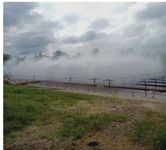
Hệ thống giải nhiệt nước tự nhiên công suất 2.000 m 3 /ngày đêm
